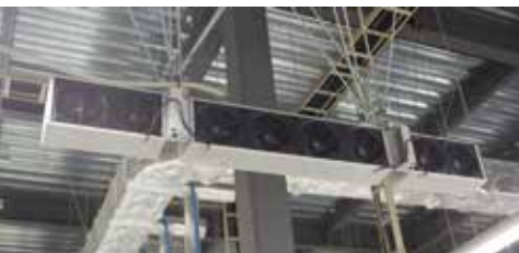
▲空気を循環させるエア―搬送ファン。右は有圧換気扇。春までにミストも設置予定
